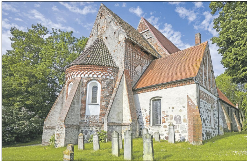
▲ Die pittoreske Dorfkirche in Altenkirchen ist die älteste Dorfkirche Rügens. Durch ihr Dach dringt Feuchtigkeit ein und der Ostgiebel muss dringend instandgesetzt werden. Foto: Deutsche Stiftung Denkmalschutz
