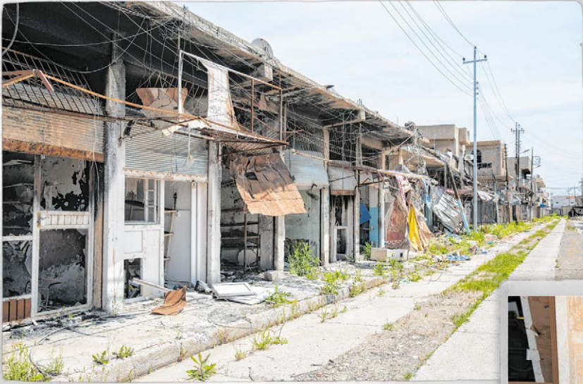
▲ Durch Beschuss und Bombardierung wurden einige Straßenzüge in Bartella in Schutt und Asche gelegt. Vor der Fassade der Kirche Sankt Georg liegen zwei beschädigte Heiligenfiguren.
