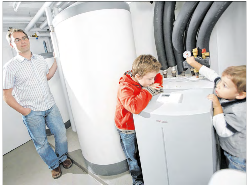
▲ Eine neue Heizung rechnet sich. Sie spart Energie, schont die Umwelt und rechnet sich auf Dauer auch finanziell. Der Staat unterstützt die Erneuerung der Heizungsanlage zudem mit attraktiven Förderungen. Fotos: gem
