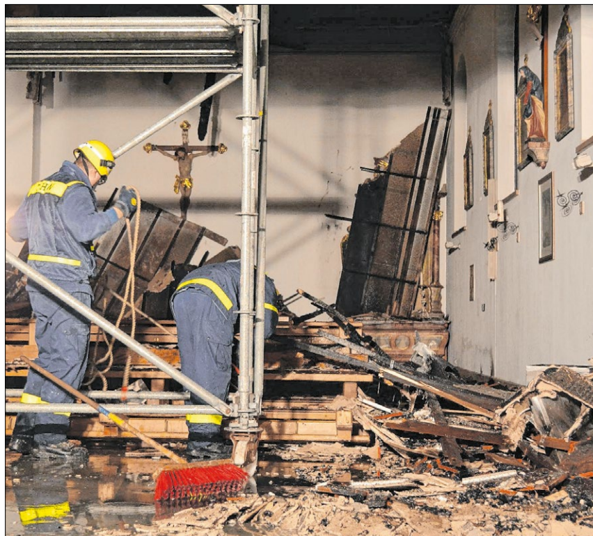
▲ Einsatzkräfte des THW-Ortsverbands Eichstätt bei Sicherheitsarbeiten in der Kirche St. Martin in Steinsdorf. Foto: THW
