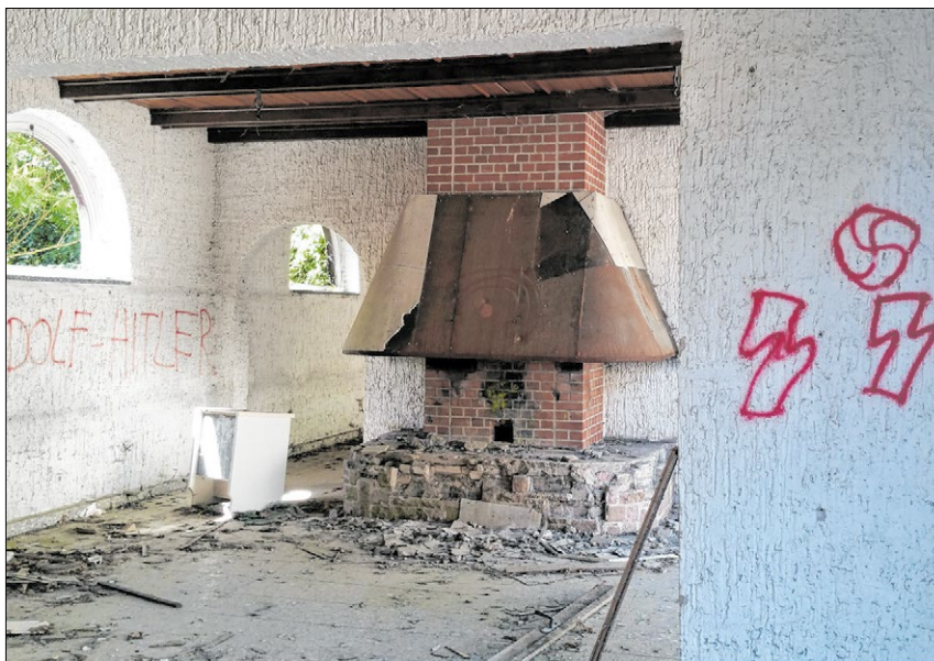
▲ Hakenkreuze, SS-Runen und Hitler-Graffiti: Der einstige Stasi-Bau von Treppeln ist völlig verwahrlost. Das Gebäude soll abgerissen werden. Fotos: Thiede
