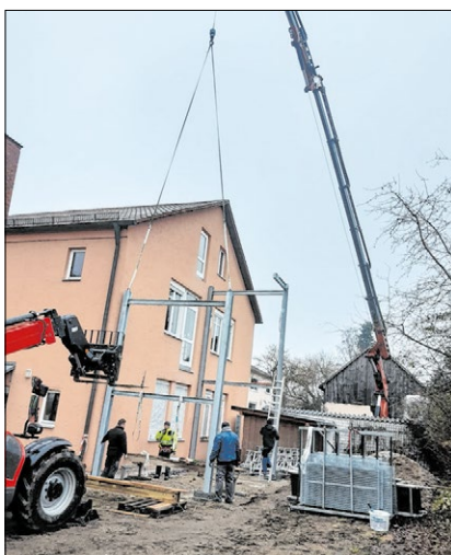
▲ Viel schweres Gerät war für den Aufbau der Treppe nötig. Foto: privat
