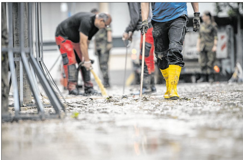
▲ Helfer befreien eine Straße in Bad Neuenahr vom Schlamm. Nach dem Aufräumen brauchen die Flutopfer dringend finanzielle Hilfe für den Wiederaufbau. Fotos: KNA
