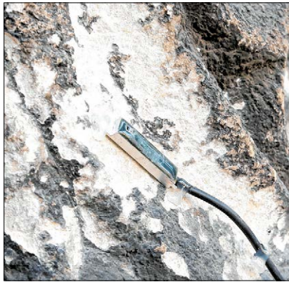
▲ Oberflächensensor am Schottenportal. Foto: Schötz
