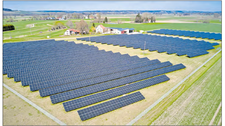
▲ Der Energiepark Donauried in Tapfheim: geplant, gebaut und betrieben von GP Joule. Foto: GP Joule
