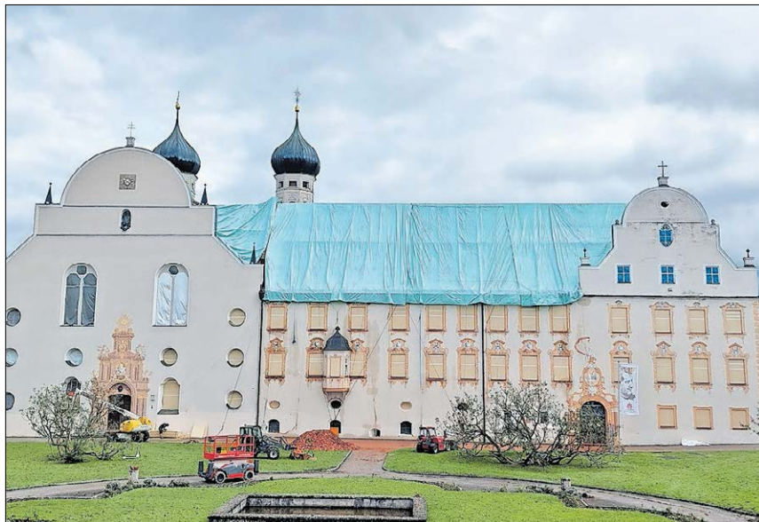
▲ In Benediktbeuern wurden Dächer von Klostergebäuden und Kirche provisorisch mit Planen abgedeckt. Foto: Kloster Benediktbeuern
