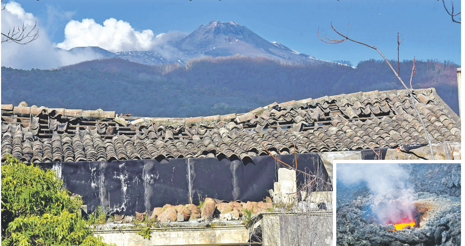
▲ Der Ätna speit nicht nur Asche und Schwefel in die Luft, sondern sorgt auch für Erdbeben. Viele Häuser sind beschädigt, hunderte Sizilianer obdachlos. Fotos: imago, gem
