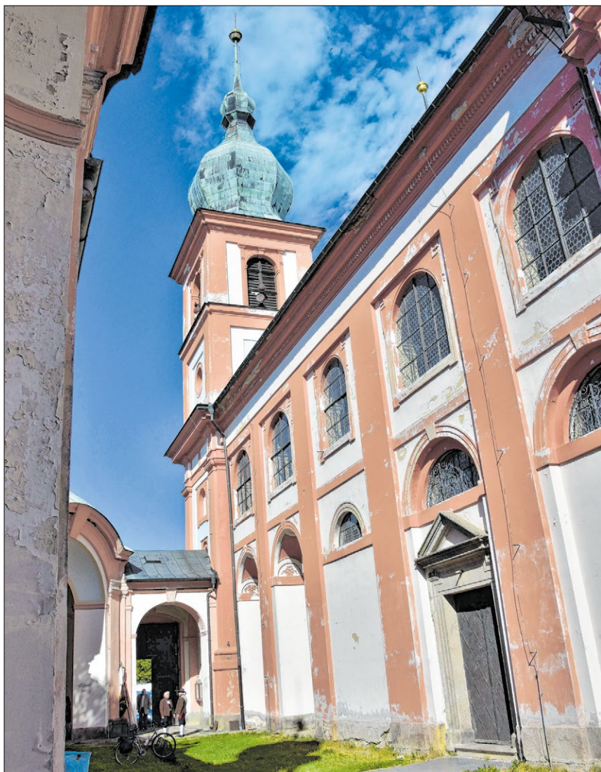
▲ An der Außenfassade und im Kreuzgang (Foto rechts) der Wallfahrtskirche Maria Kulm werden die durch Vernachlässigung während des Kommunismus entstandenen Schäden sichtbar. Für die Restaurierung sammelt der Förderverein Spenden.
