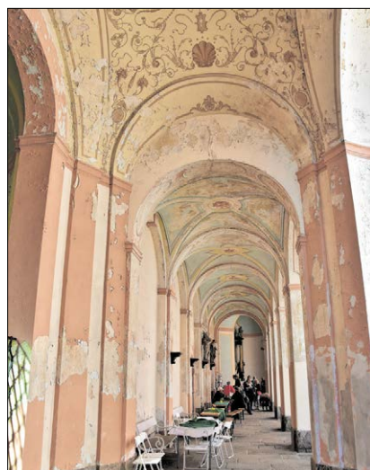
▲ Im Kreuzgang werden die durch Vernachlässigung während des Kommunismus entstandenen Schäden sichtbar. Für die dringend nötige Restaurierung sammelt der Förderverein Spenden.
