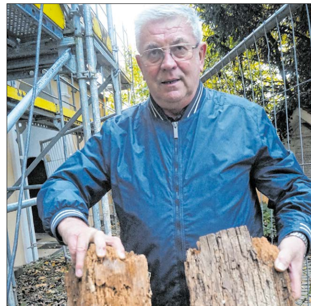
Kirchenpfleger Josef Mauser zeigt durch Feuchte-Einwirkung zersetztes Holz der Mauerlatten.
