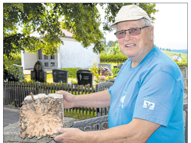
► Kirchenpfleger Siegfried Maier zeigt ein von Trockenfäule befallenes Holzteil, das ersetzt worden ist.
