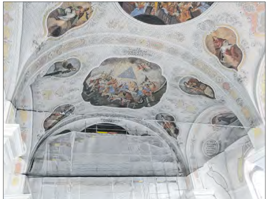
▲ Die Stange in der Mitte des Bildes ist das sichtbare Bauteil eines Zugankers, eines Bauteils zur Stabilisierung des Gewölbes, von denen fünf Stück in der Dillinger Basilika eingesetzt wurden. Unten rechts sind im Seitenschiff die Risse zu erkennen, die geschlossen werden mussten. Fotos: Gah
