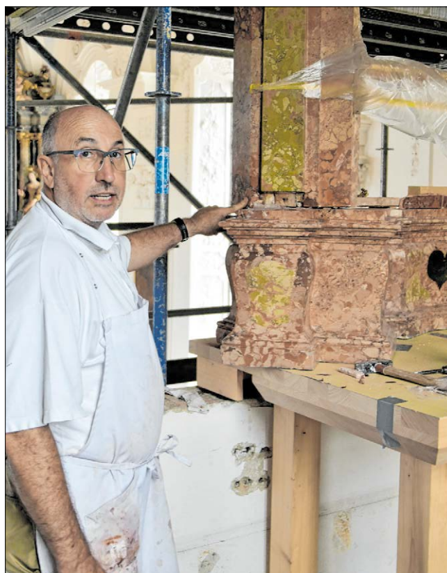
◀ Restaurator Thomas Salveter mischt kunstvoll winzig kleine Gipshäufchen mit Natur-Erdfarben, mit denen er in einer peniblen Sisyphus-Arbeit bei den beiden Altären mit einer kleinen Fugenkelle die Beschädigungen ausbessert.
