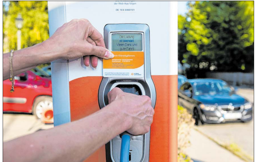
▲ Für die Installation einer Strom-Ladestation gibt es einen staatlichen Zuschuss. Foto: erdgas schwaben
