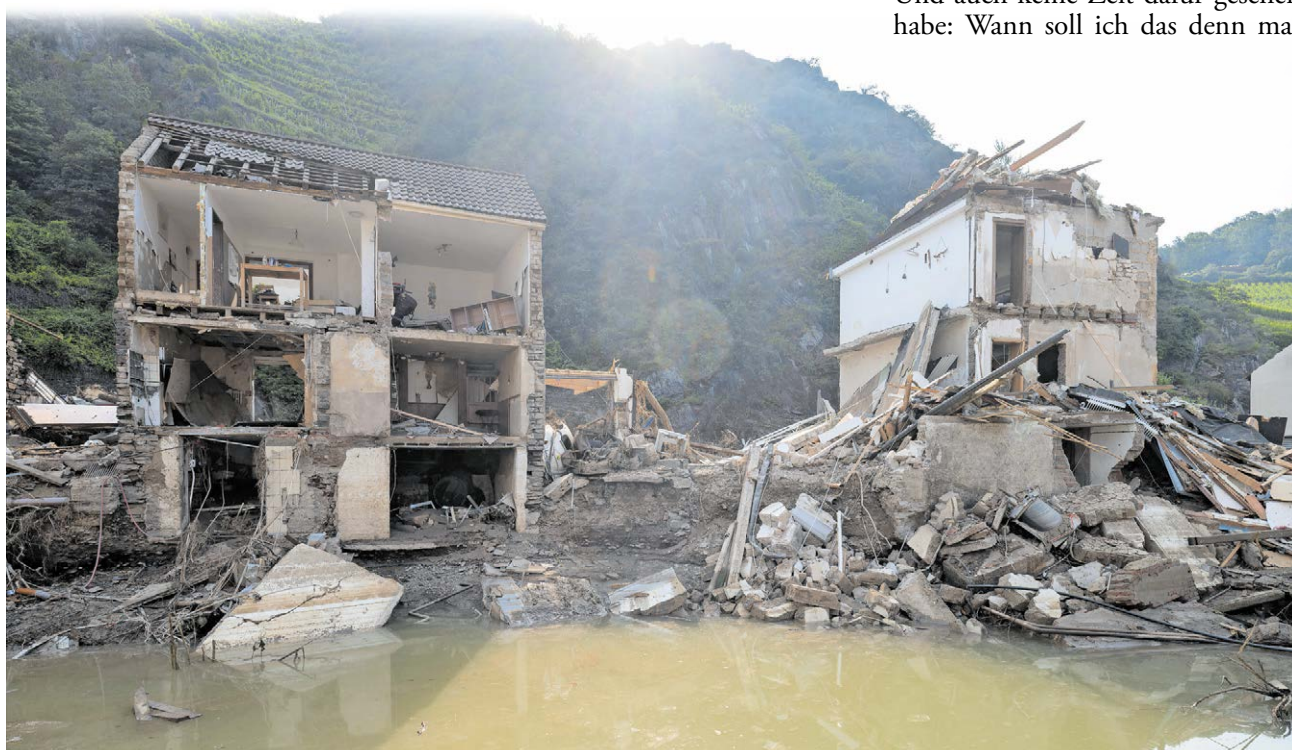
▲ Das Örtchen Mayschoß nach der Katastrophe. Die Zerstörungen, die die Flut hinterließ, sind noch nicht überall beseitigt.
