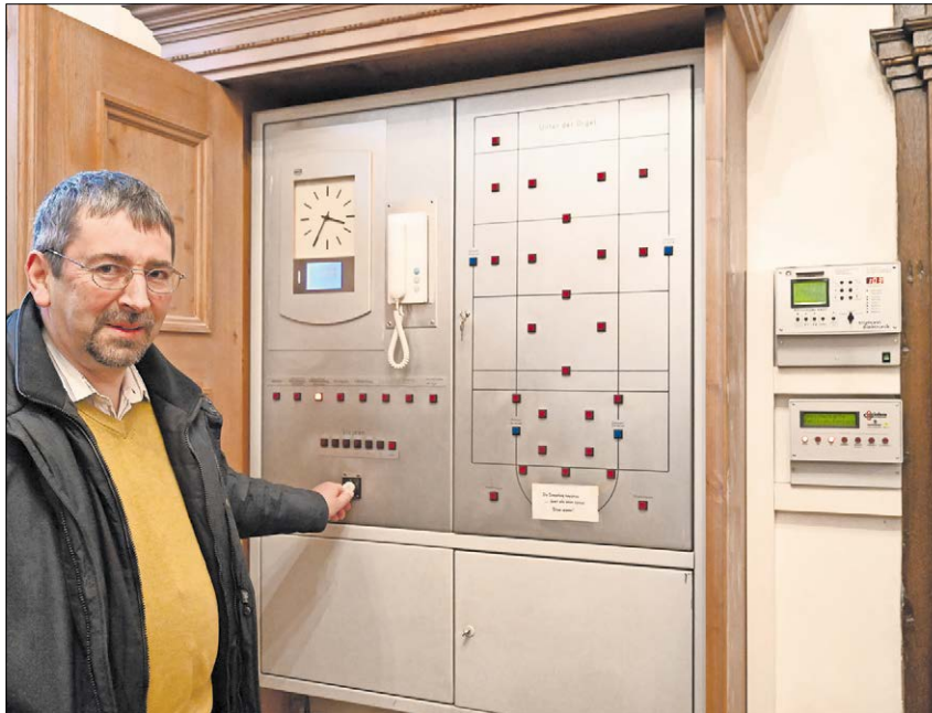
▲ Mesner Klaus Probst steuert die Temperaturregelung in der Basilika St. Peter in Dillingen an der Donau. Fotos: Gah
