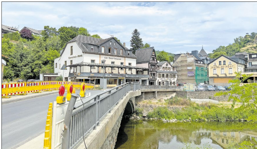
▲ Das Wasser ist zurückgegangen, doch die Brücke über die Ahr in Altenahr ist bis heute nur provisorisch gesichert. Im Hintergrund ist das arg in Mitleidenschaft gezeichnete „Hotel zum schwarzen Kreuz“ zu sehen. Fotos: KNA
