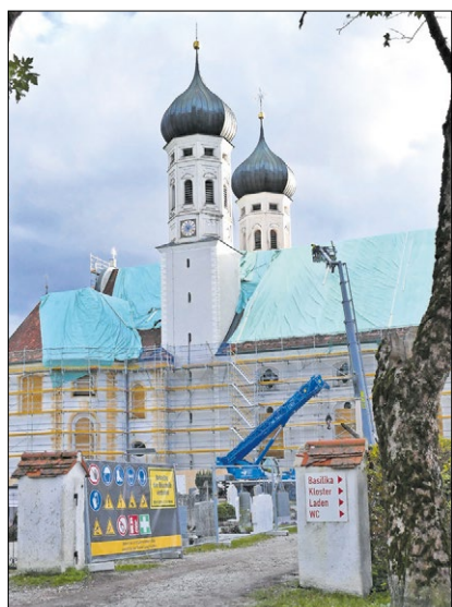
▲ Auch das Dach der Kirche und die Orgel wurden schwer beschädigt.
