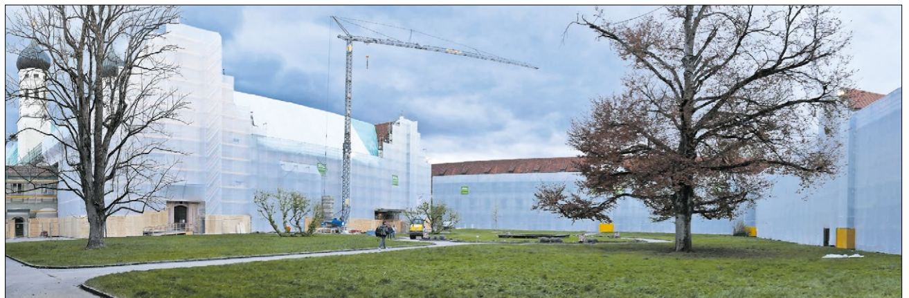
▲ Das Klosterareal in Benediktbeuern ist eine Großbaustelle, sämtliche Gebäude sind eingerüstet. Nachdem man Hochschule und Jugendbildungsstätte wieder öffnen konnte, sollen nach und nach weitere Bereiche hergerichtet werden. Fotos: Paulus
