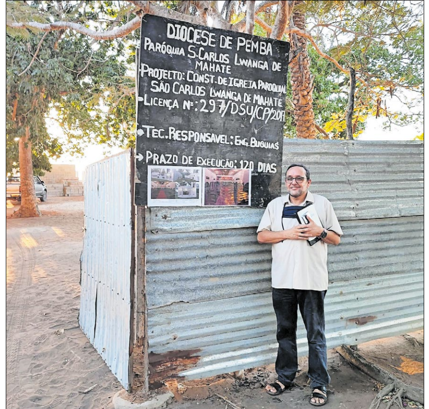
▲ Eduardo Andrés Roca Oliver, Leiter des interreligiösen Zentrums in Pemba, vor der Baustelle der Kirche „St. Karl Lwanga“.
