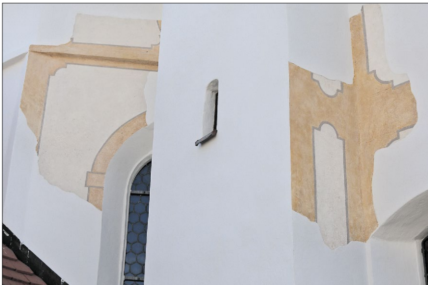
▲ Erhalten blieben auch Teile solcher Malereien, wie sie sich ursprünglich um die ganze Kirche zogen. Foto: Wimmer
