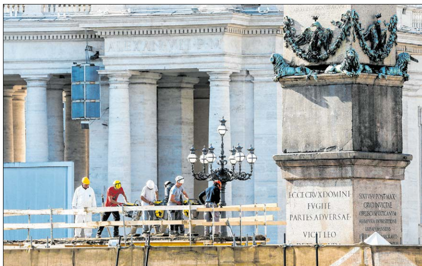
▲ Arbeiter befestigen Sand als Untergrund für eine Krippe auf dem Petersplatz. Künftig entscheiden im Vatikan Fachausschüsse über die Vergabe von Aufträgen. Foto: KNA
