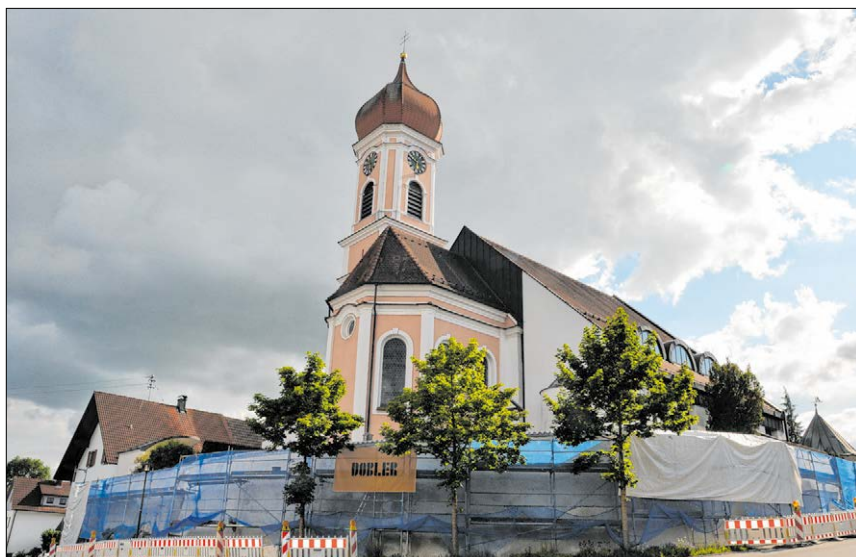
▲ Nach Jahren der Planung wird der nordöstliche Teil der Kirchenmauer um die Pfarrkirche St. Martin derzeit saniert. Foto: Bader
