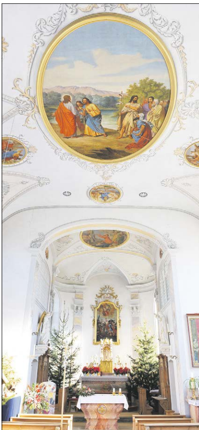
▲ Heiter wirkt St. Andreas im Inneren. Der Hochaltar war wegen des desolaten Daches von Feuchtigkeit bedroht. Im Deckenfresco weist Johannes der Täufer seinen Jünger Andreas auf Jesus hin.
