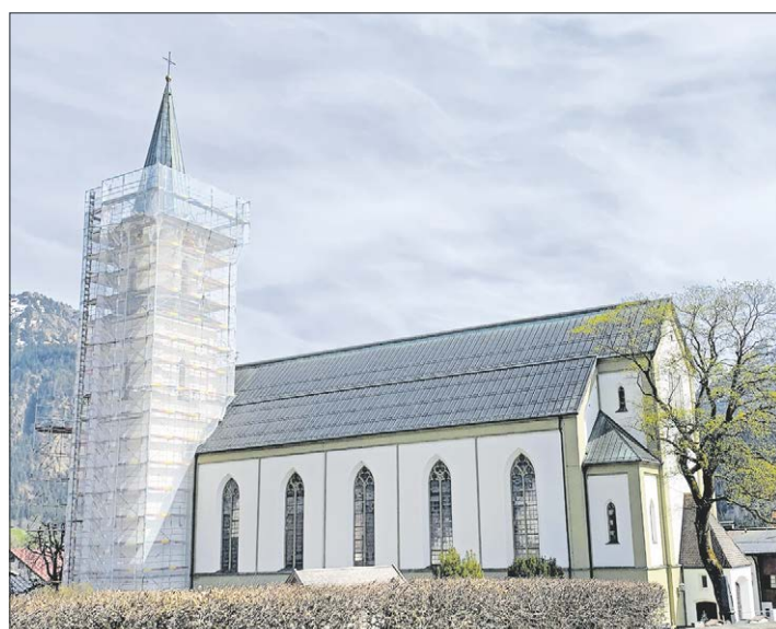
◀ Die Pfarrkirche von Bad Hindelang ist derzeit teilweise eingestülpt. Sie wird auch die „Kathedrale des Ostrachtals“ genannt.
