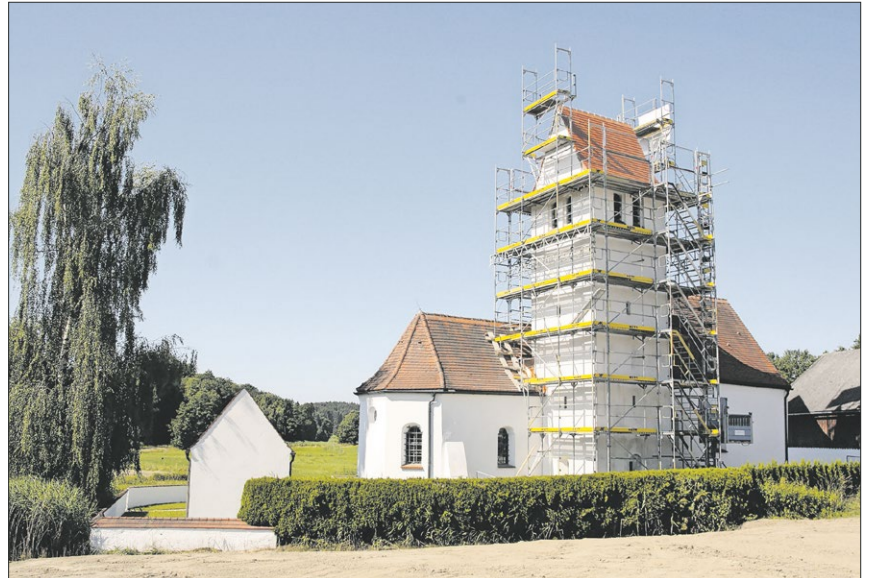
▲ Rund ein Jahr dauerten die statischen Instandsetzungsarbeiten am Kirchturm und die Innensanierung im Chorraum. Die Aufnahme entstand im Juli 2022, das Gerüst mit dem Lastenaufzug ist längst wieder abgebaut. Fotos: Schmidberger
