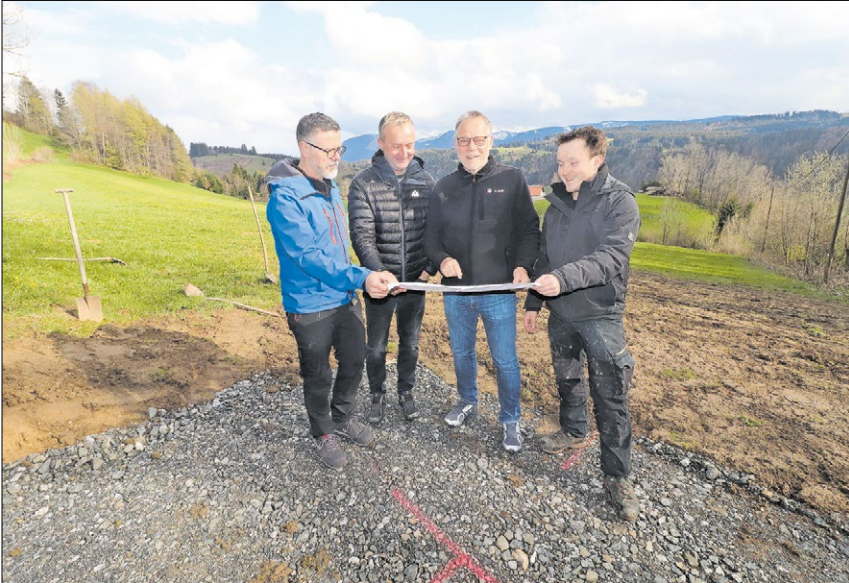
▲ Auf die St.-Nikolaus-Kapelle mit Fernblick freuen sich auf der bereits gekiesten Baustelle (von links): Fördervereinsvorsitzender Manfred Bader, Grundstückseigentümer Christian Mayer, Initiator Franz Horn und zweiter Vorsitzender Florian Lerpcher. Foto: Winkler
